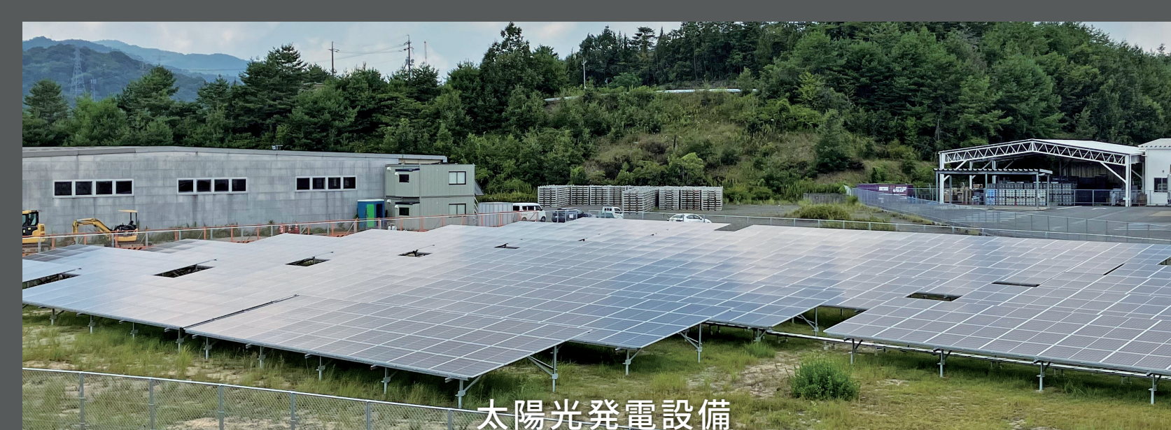
太陽光発電設備
